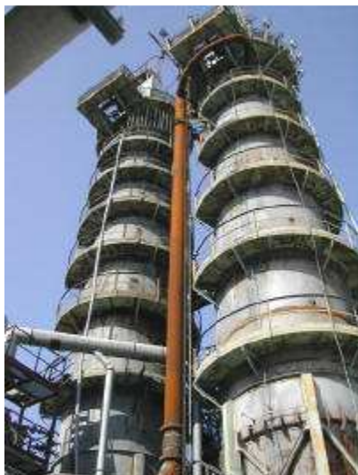
Forni da calce per produrre il latte da calce, necessario per purificare lo zucchero.
